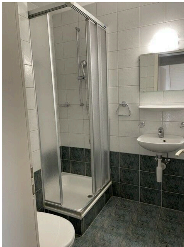
Salle d'eau douche
